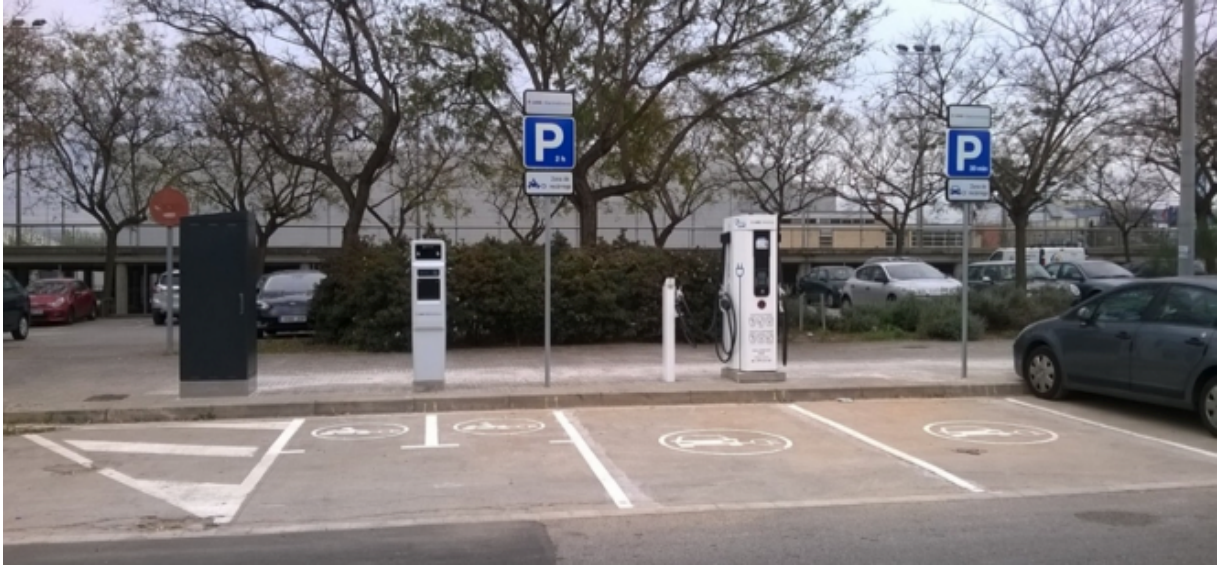
Figura 2. Electrolinera de Gavà
